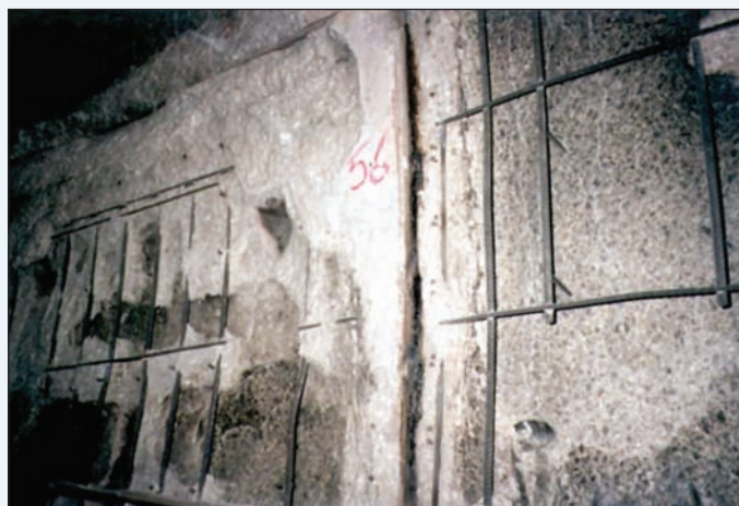
Figura 9 - Lo spalling nel calcestruzzo
