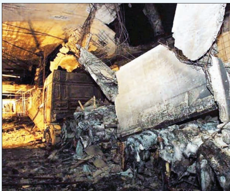
Figura 8 - Il crollo della volta di un tunnel a seguito di incendio
