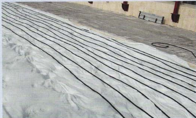
Impianto di subirrigazione posato sui materassi di igroperlite.
